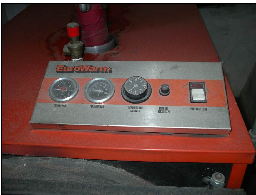
Figura 13: Sottosistema di generazione – Pannello di controllo caldaia STATO DI FATTO
