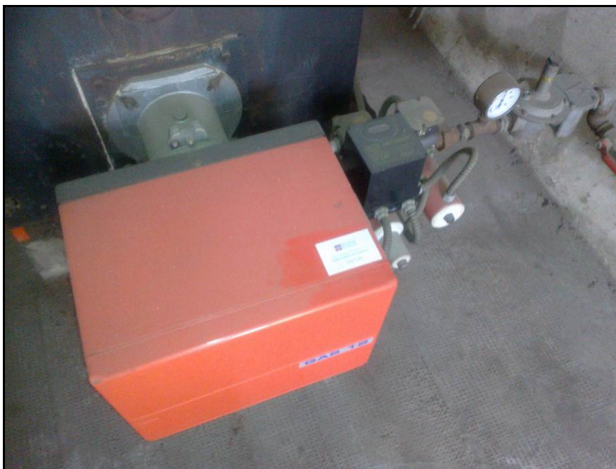
Figura 12: Sottosistema di generazione - Dettaglio bruciatore STATO DI FATTO
