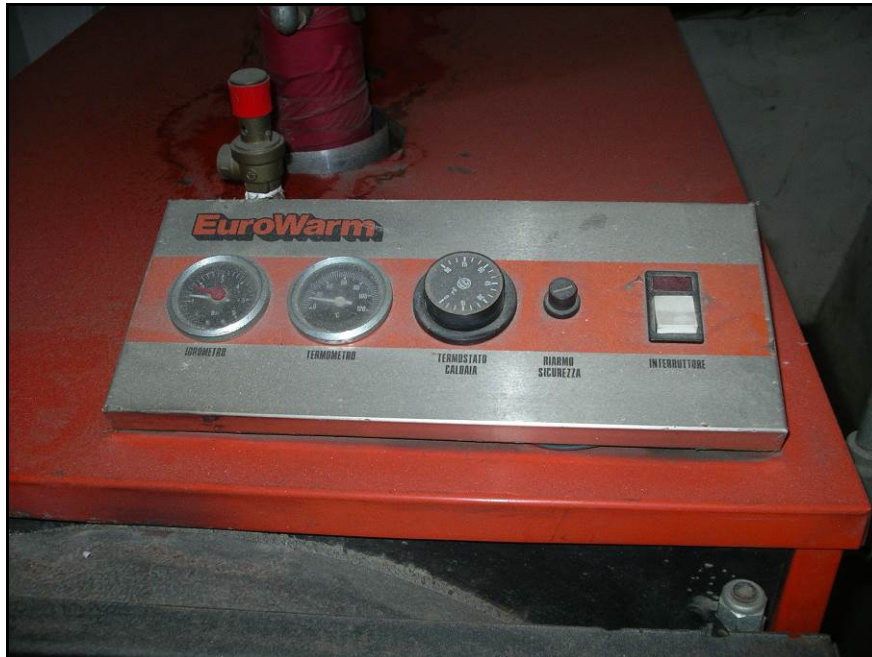
Figura 17: Sottosistema di regolazione – Termostato di caldaia STATO DI FATTO
