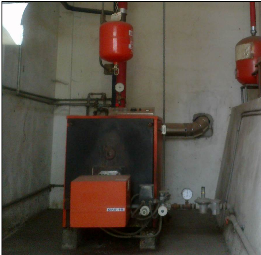
Figura 11: Sottosistema di generazione – Caldaia a gas metano STATO DI FATTO
