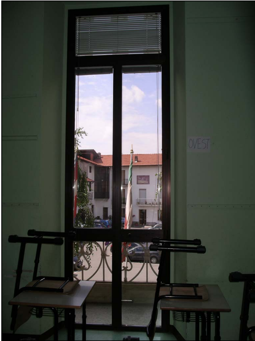
Figura 8: Porta-finestra “tipo” esistente STATO DI FATTO
