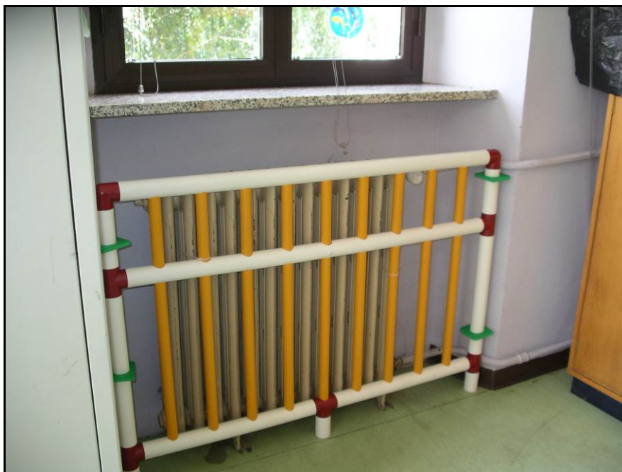
Figura 15: Sottosistema di emissione – Radiatore in ghisa STATO DI FATTO
